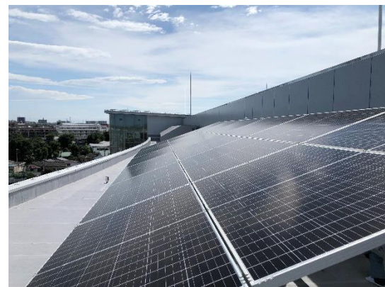
屋上 太陽光発電設備
